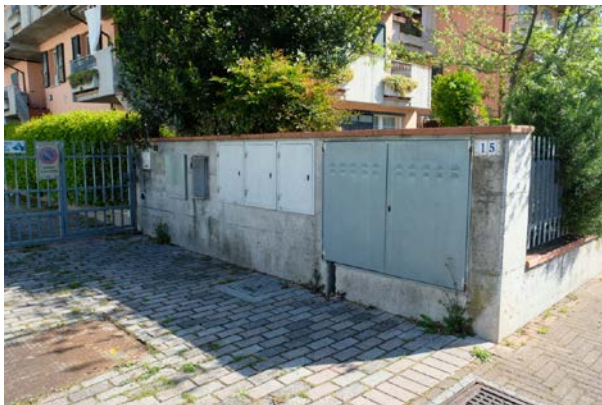
nicchie contatori ubicate all'esterno della recinzione
