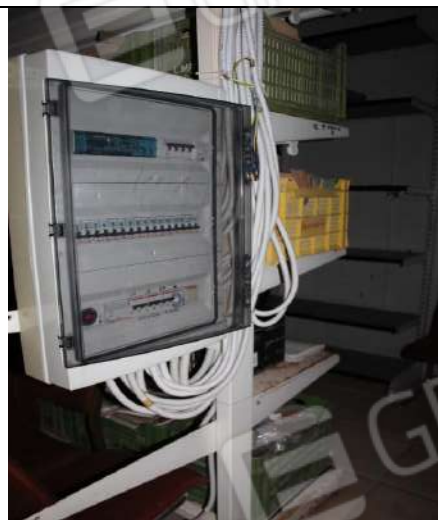
PARTICOLARE DI UN QUADRO ELETTRICO AL PRIMO PIANO
