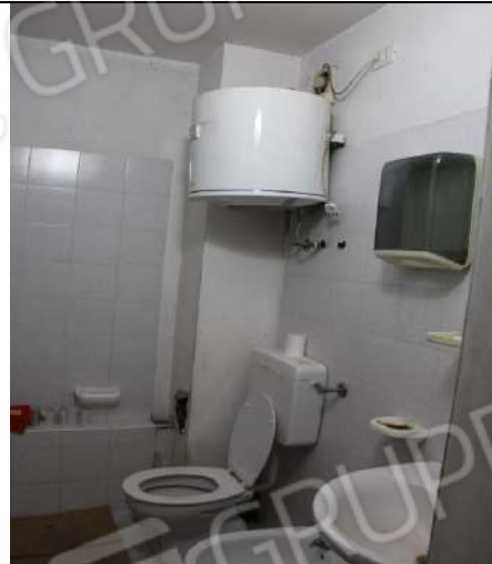
SERVIZIO IGIENICO 2 CON BOILER
