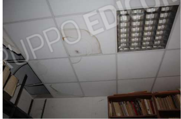
PARTICOLARE INFILTRAZIONI D'ACQUA DALLA COPERTURA AI LOCALI PIANO PRIMO
