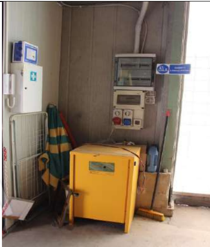
PARTICOLARE QUADRO ELETTRICO AL DEPOSITO
