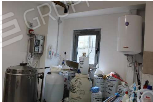
LOCALI AL PIANO TERRA CON BOILER
