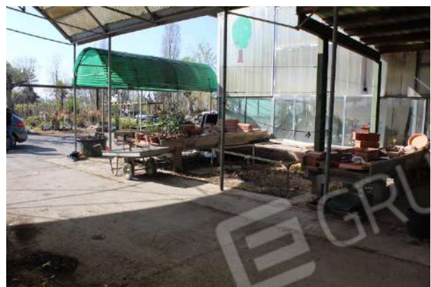
STRUTTURE A COPERTURA CORTE ESTERNA LATO STRADA, IN PARTE COLLABENTI
