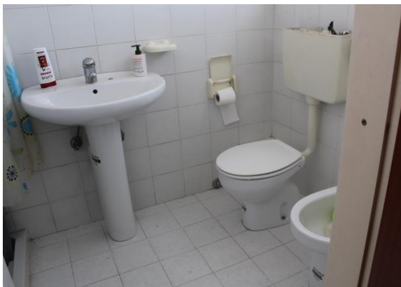
BAGNO AL PIANO PRIMO, ABUSIVO E NON SANABILE
