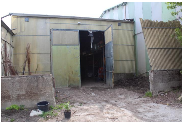
DEPOSITO ABUSIVO, ADIACENTE IL CORPO A NORD.
