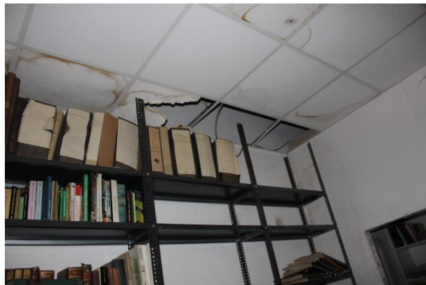
PARTICOLARE INFILTRAZIONI D'ACQUA AL PIANO PRIMO
