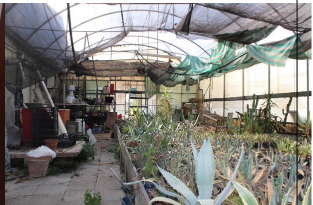
SERRA AL PIANO TERRA, ABUSIVA E NON SANABILE
