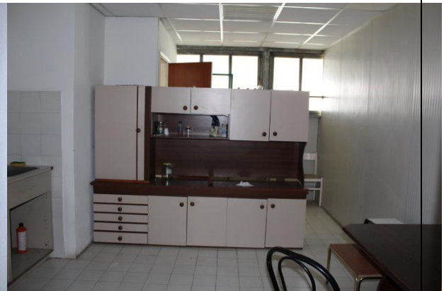
LOCALI PIANO PRIMO, ABUSIVI E NON SANABILI
