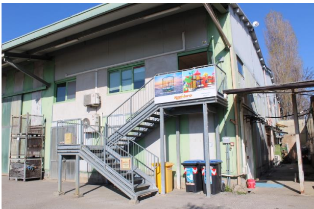
SCALA ESTERNA PER ACCESSO AL PIANO PRIMO. TRATTASI DI PIANO INTERAMENTE ABUSIVO E NON SANABILE
