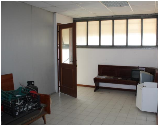
LOCALI PIANO PRIMO, ABUSIVI E NON SANABILI
