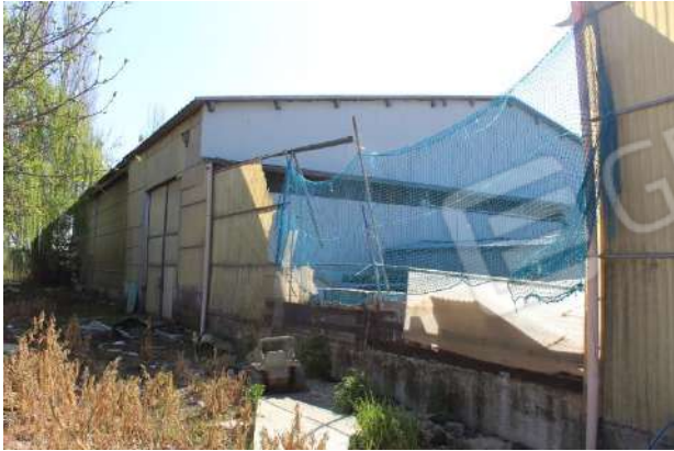
PARTICOLARE CORPO SUL RETRO E SERRE COLLABENTI
