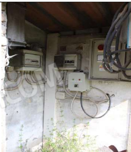
MANUFATTO IN MURATURA, CONTENENTE QUADRI ELETTRICI
