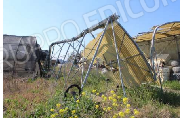
SERRE COLLABENTI CON ACCUMULI DI RIFIUTI
