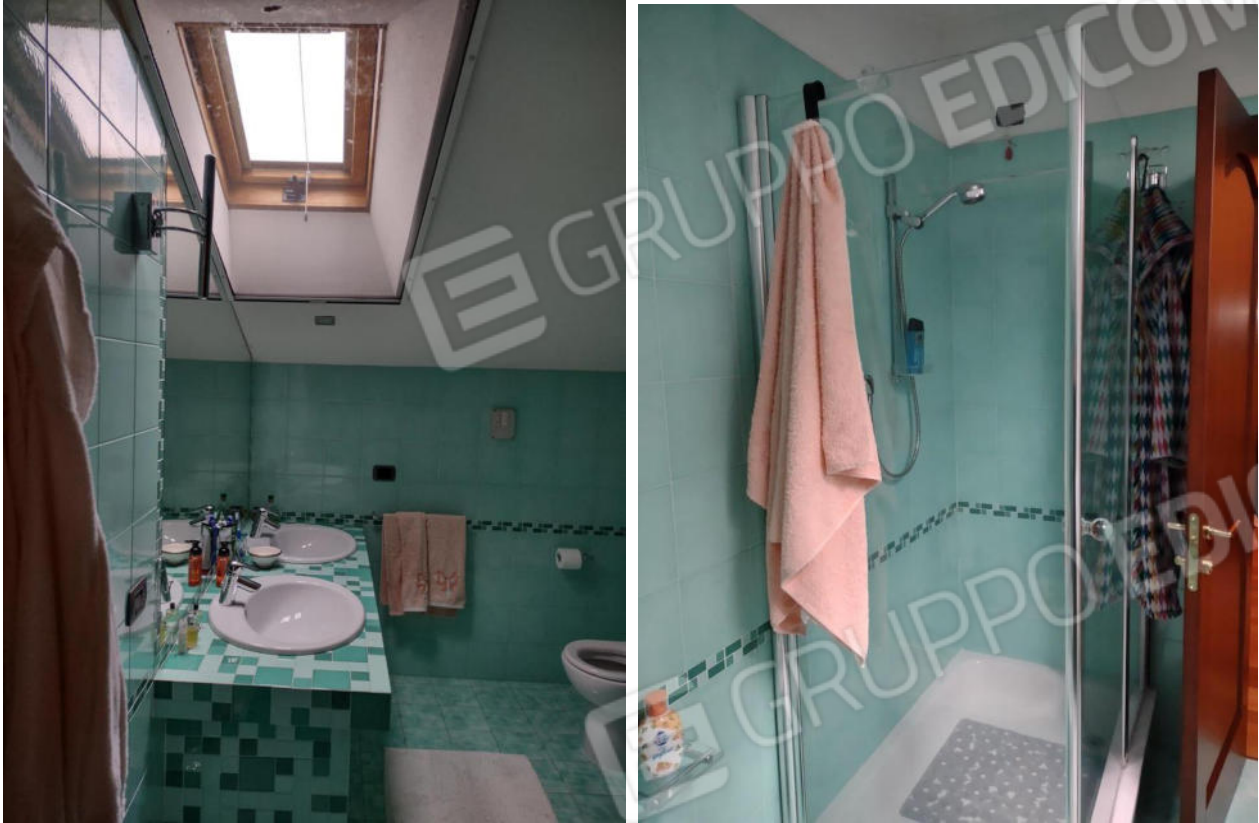
FOTO 21 e 22. Piano sottotetto: il bagno non autorizzato
