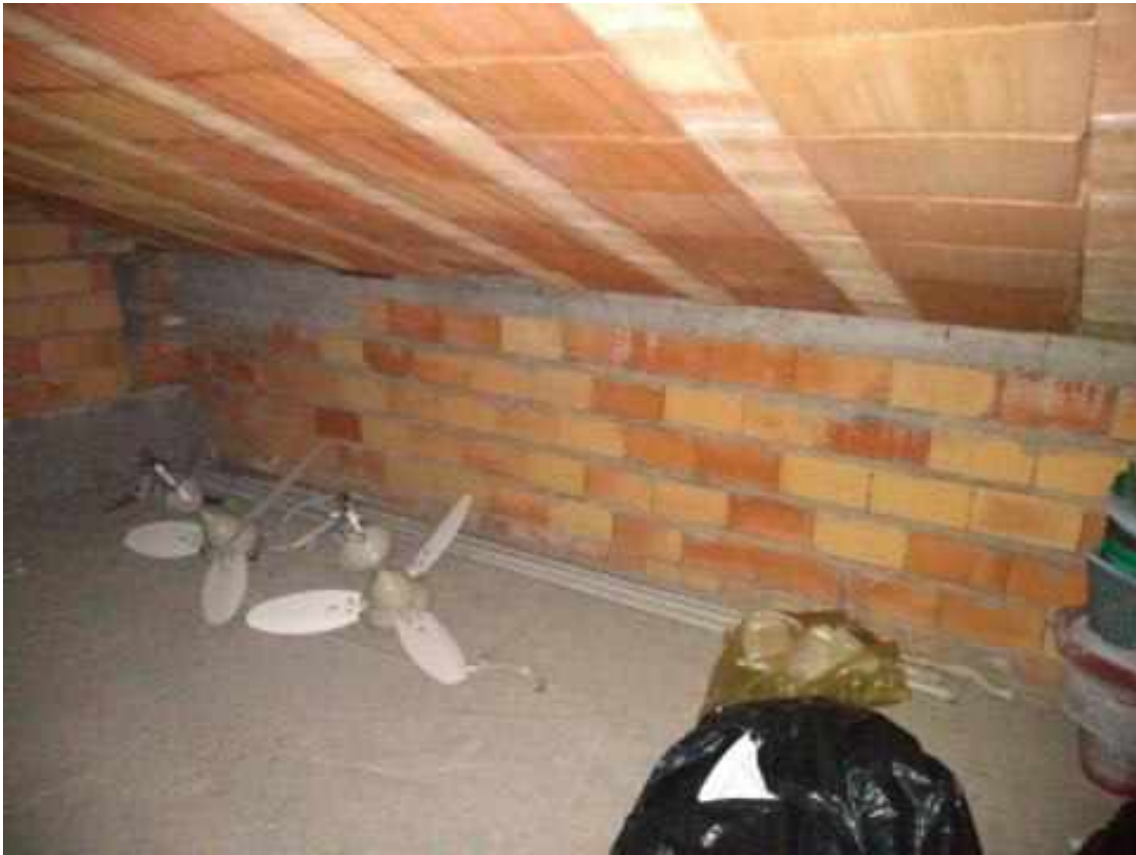
FOTO 44. Sottotetto: porzione con altezza media inferiore a 1 m. priva di rifiniture
