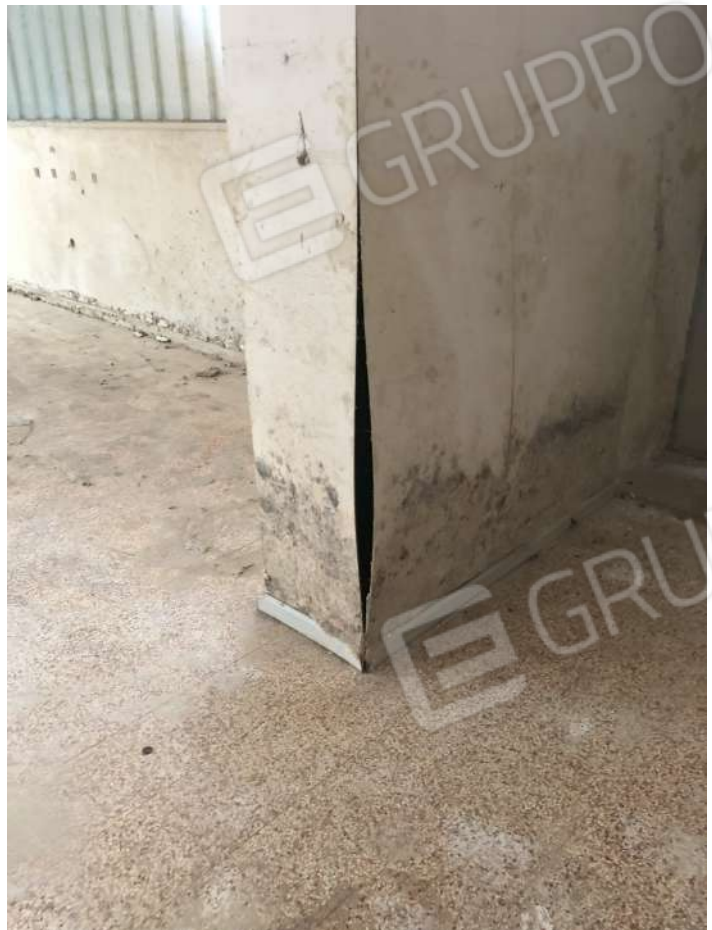
Foto 16- Piano 1° seminterrato – mostra (dettaglio danno da alluvione)
