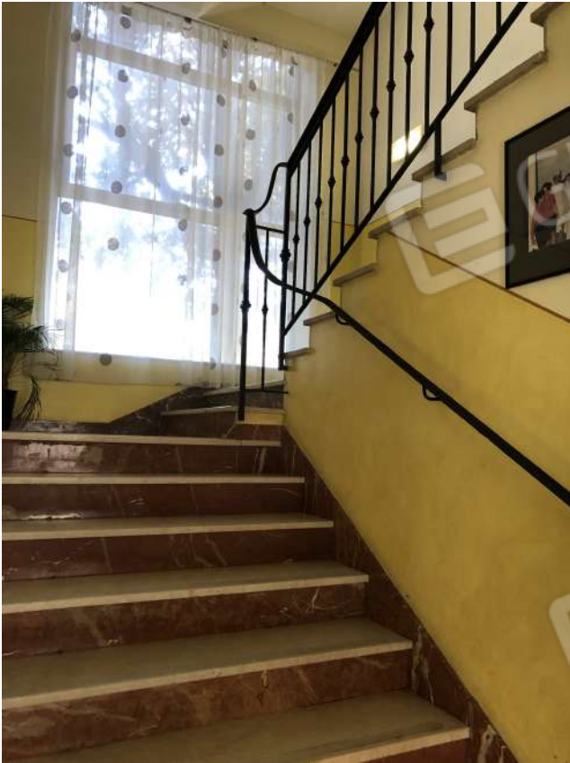
Foto 23- Vano scala al 1° piano
