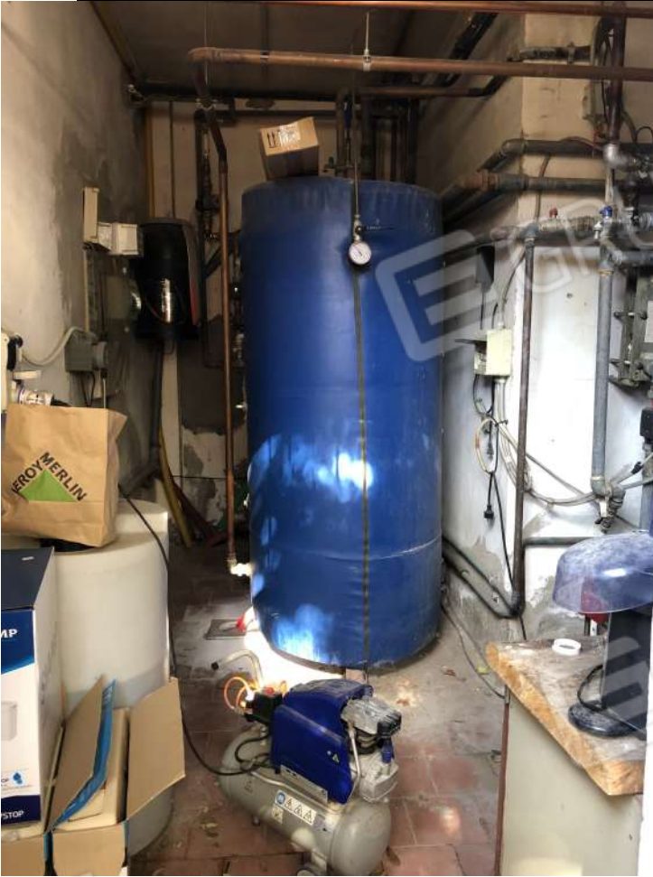
Foto 21- Locale Tecnico (C.T.)
