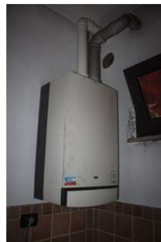
Foto 11: caldaia murale in bagno
