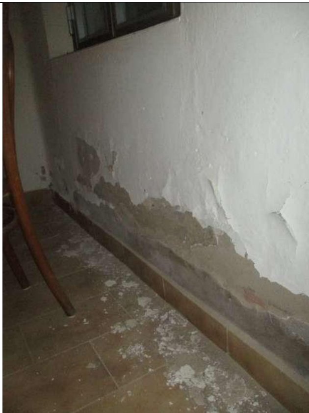
Stato di ammaloramento della muratura interna.
