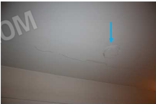
Foto 48: tracce di infiltrazioni sul soffitto del soggiorno
