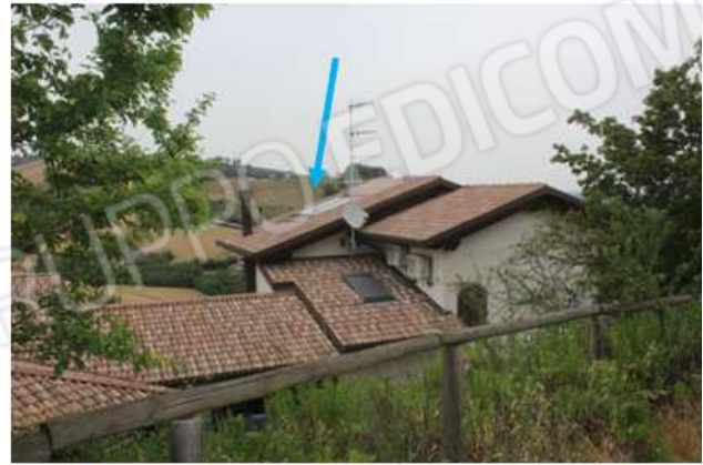
Foto 83: pannelli solari termici sopra abitazione lotto1
