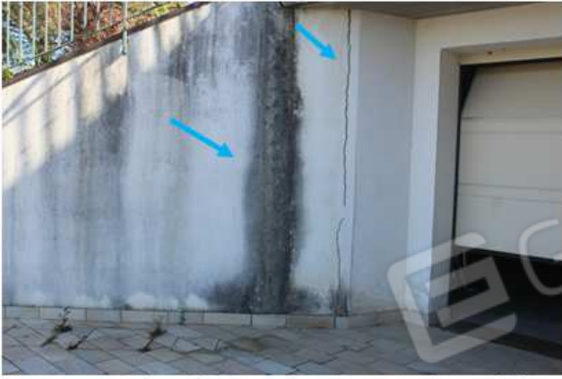
Foto 52: macchie e lesioni nel paramento a fianco del garage
