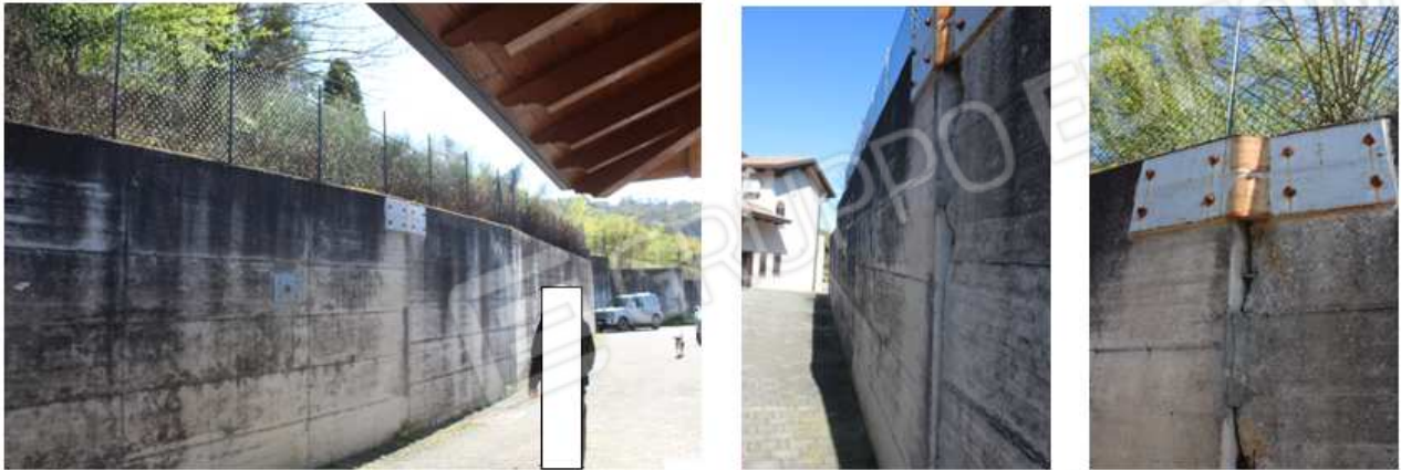
Foto 14-15-16: muro di sostegno sud e dettagli assestamenti e consolidamenti
