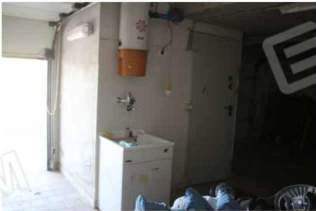
Foto 73: locale tecnico – esterno
