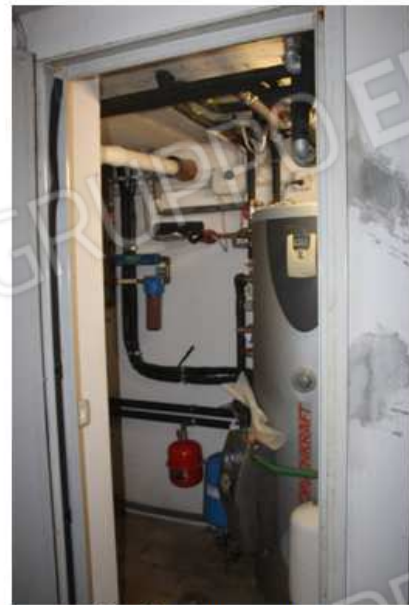
Foto 74: locale tecnico - interno
