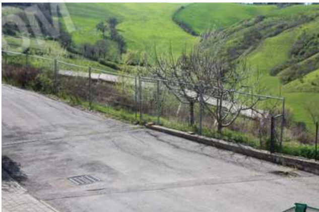
Foto 10: area di sosta collassata
