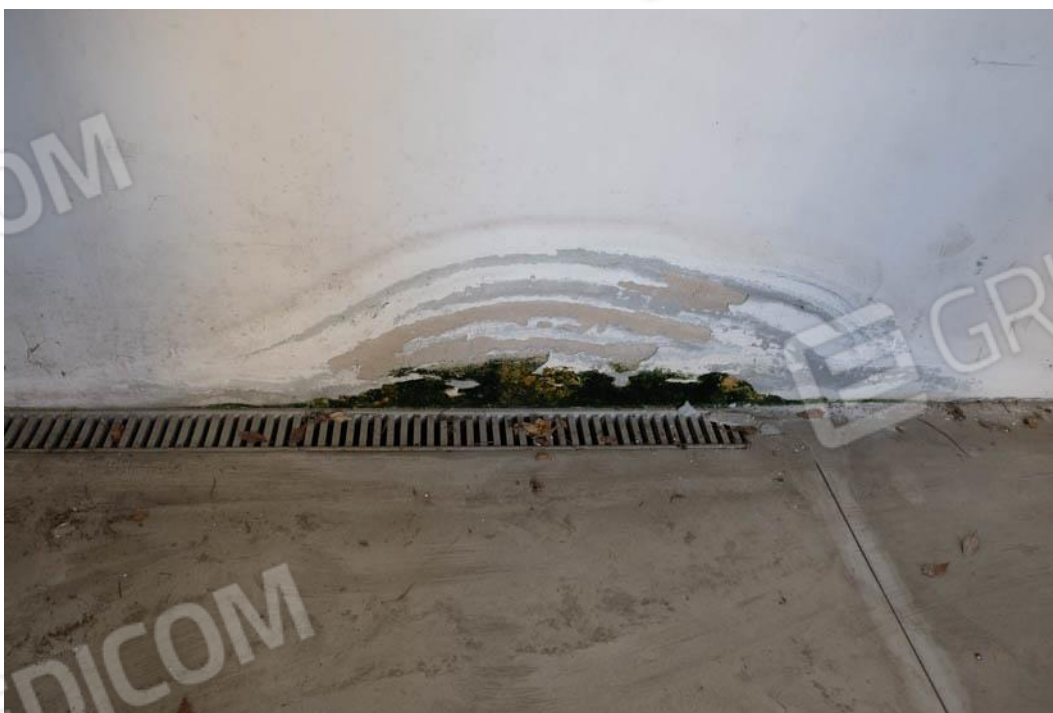
Foto n.93 – particolare dei segni dell'umidità risalente presente nell'area di manovra ad uso comune alle autorimesse poste al piano interrato
