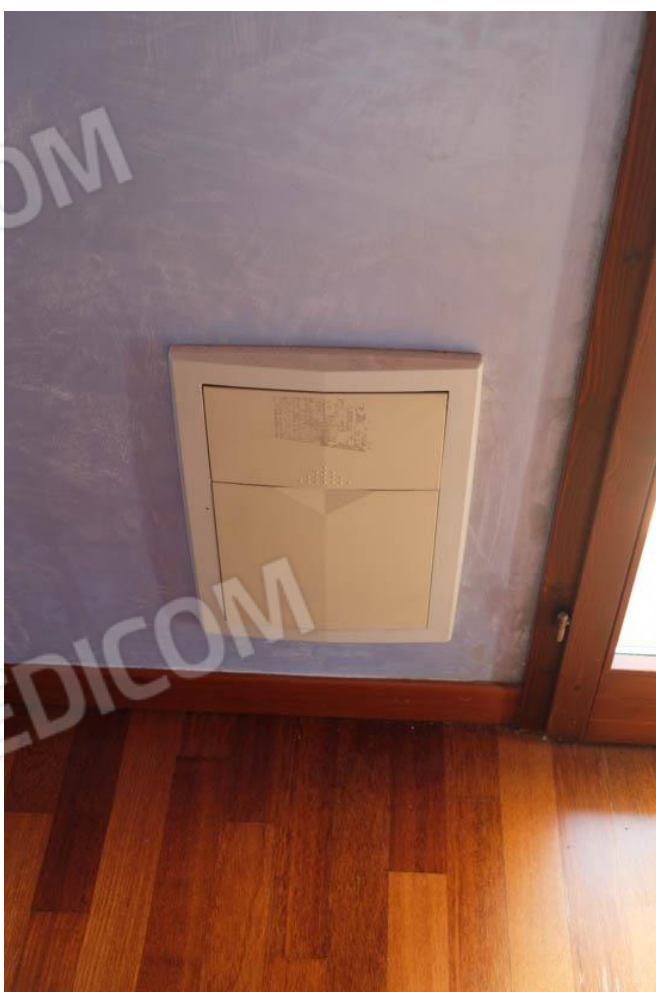
Foto n.41 – particolare impianto di aspirazione centralizzato posto nel locale di servizio, utilizzato come camera, ubicato al piano secondo (sottotetto)
