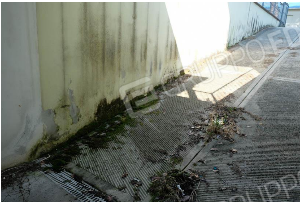
Foto n.92 – particolare dei segni dell'umidità risalente presente nello scivolo e nell'area di manovra ad uso comune alle autorimesse poste al piano interrato
