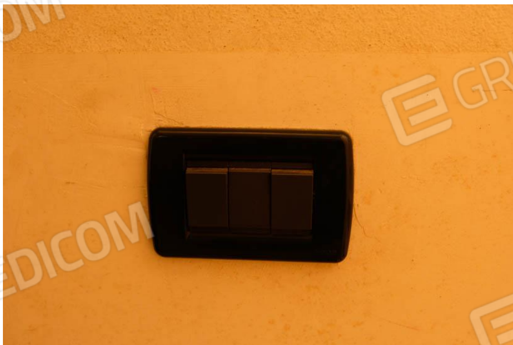
Foto n.99– particolare delle placche di finitura dell'impianto di illuminazione presente all'interno dell'abitazione
