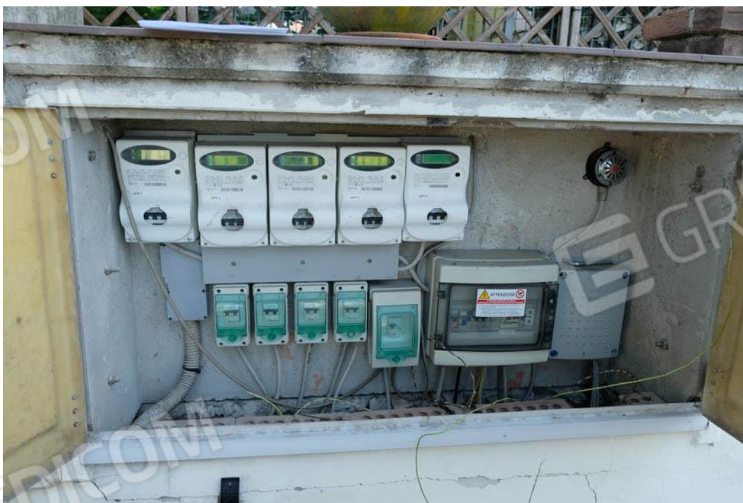
Foto n.101– particolare dei contatori luce elettrica
