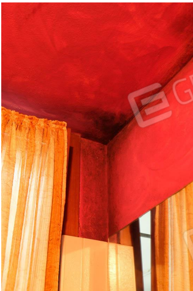
Foto n.80 – particolare manifestazione di muffa nel soffitto del w.c. posto al piano interrato
