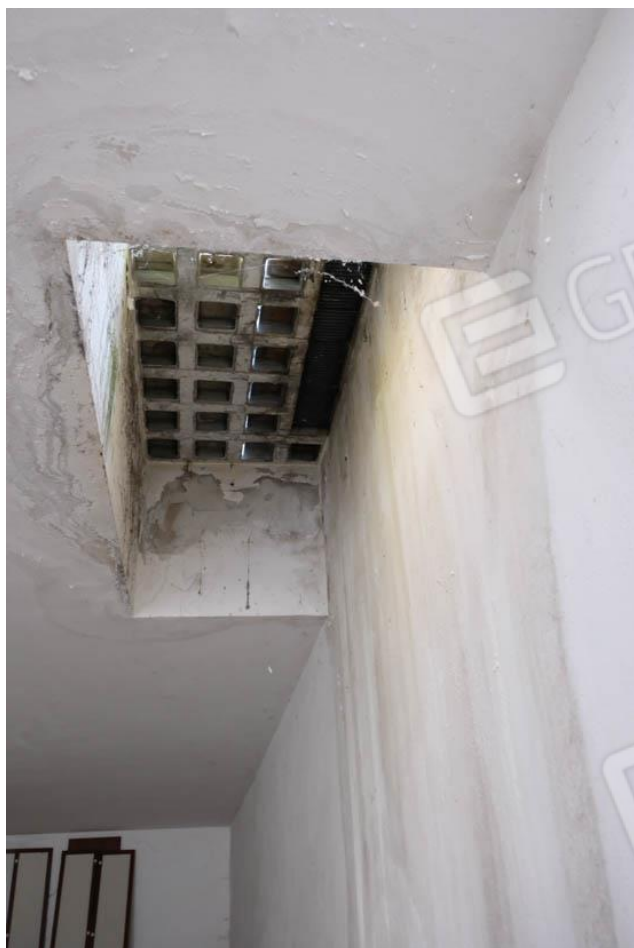
Foto n.94– veduta lucernaio/bocca di lupo presenti nell'area di manovra dell'accesso alle autorimesse poste al piano interrato, e nelle corti delle singole u.i.
