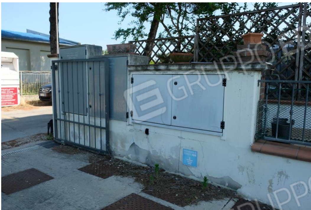
Foto n.100– veduta contenitori dei contatori luce elettrica, acqua e gas
