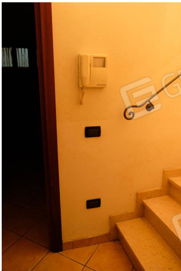
Foto n.98– particolare impianto di illuminazione presente all'interno dell'abitazione
