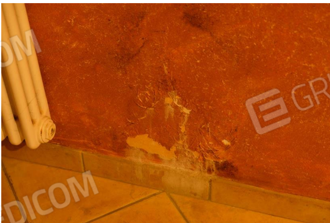
Foto n.73 – particolare delle tracce di umidità risalente nel locale di servizio, utilizzato ed attrezzato a cucina-pranzo, posto al piano interrato
