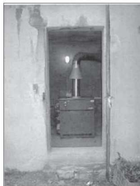
FOTO STORICA - CALDAIA PALAZZO
