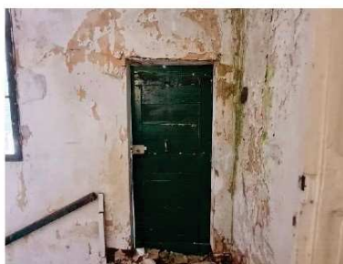
FOTO 76 - ALA A SERVIZI INFILTRAZIONI DALLA COPERTURA
