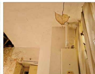
FOTO 98 - PORZIONI DI CONTROSOFF. AMMALORATE A RISCHIO CROLLO
