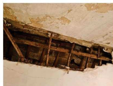
FOTO 74 - PORZIONE COPERTURA DEGRADATA
