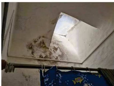
FOTO 78 - ALA A SERVIZI INFILTRAZIONI LUCERNAIO
