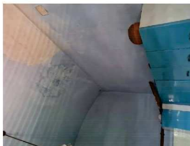
FOTO 79 - UMIDITA' DA CONDENZA
