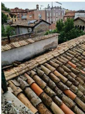
FOTO 84 - INFILTRAZIONE TETTO FABBR. A SERVIZI
