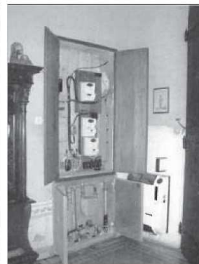
FOTO STORICA - VANO CONTATORI
