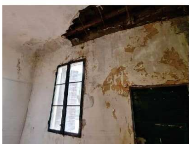
FOTO 72 - ALA SERVIZI PORZIONE DI COPERTURA CROLLATA
