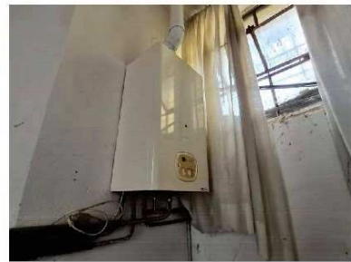
FOTO 93 - CALDAIA FABBRICATO A SERVIZI
