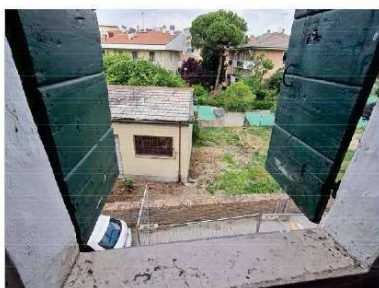
FOTO 89 - SCURONI FINESTRE FABBRICATO A SERVIZI
