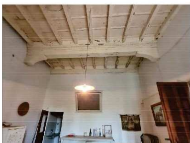
FOTO 88 - PIANO TERRA SOFFITTO VANO PRANZO
