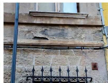
FOTO 96 - FACCIATA PRINCIPALE USURA E DISTACCHI
