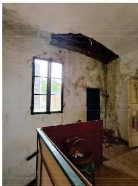
FOTO 68 - ALA SERVIZI DEGRADO COPERTURA
