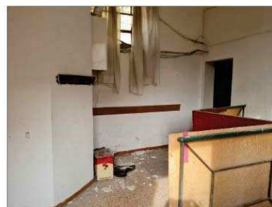
FOTO 97 - ALA A SERVIZI CON PROBLEMI STRUTTURALI
