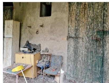
FOTO 80 - PIANO INTERRATO DEGRADO, INFILTRAZIONI E UMIDITA'
