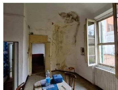
FOTO 77 - ALA A SERVIZI CUCINA CON INFILTRAZIONI
