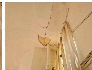
FOTO 99 - CONTROSOFFITTO A RISCHIO CROLLO
