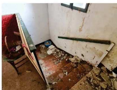
FOTO 73 - MACERIE DEL CROLLO STRUTTURALE
