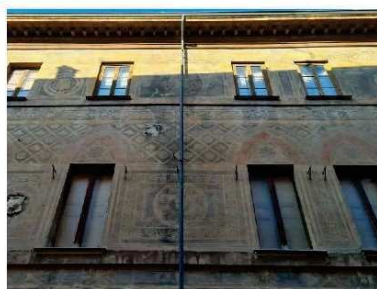
FOTO 95 - FACCIATA PRINCIPALE USURA E DISTACCO VERNICIATURA
