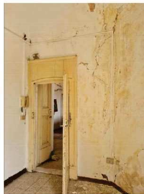
FOTO 70 - INFILTRAZIONI DA COPERTURA
