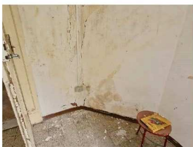
FOTO 75 - ALA A SERVIZI INFILTRAZIONI E UMIDITA'
