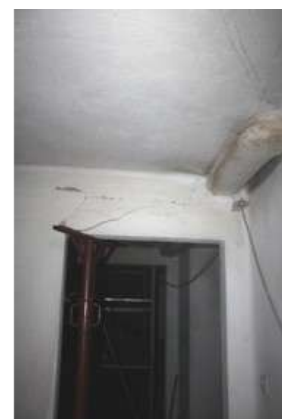
Foto 31: architrave lesionata all'interrato
