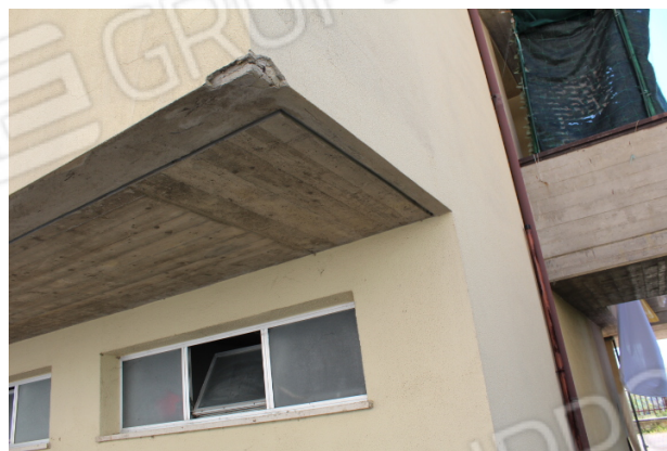
PARTICOLARE DISTACCO DI CALCESTRUZZO, IN ANGOLO NORD-OVEST, PIANO PRIMO
