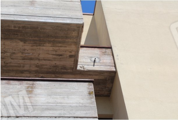
PARTICOLARE DISTACCHI DI CALCESTRUZZO
