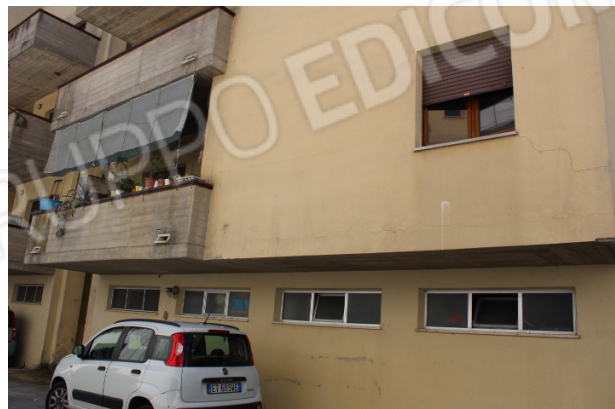
PROSPETTO NORD, PIANO TERRA CON PARTICOLARE TUBO DI EMISSIONE FUMI DELLA CALDAIA
