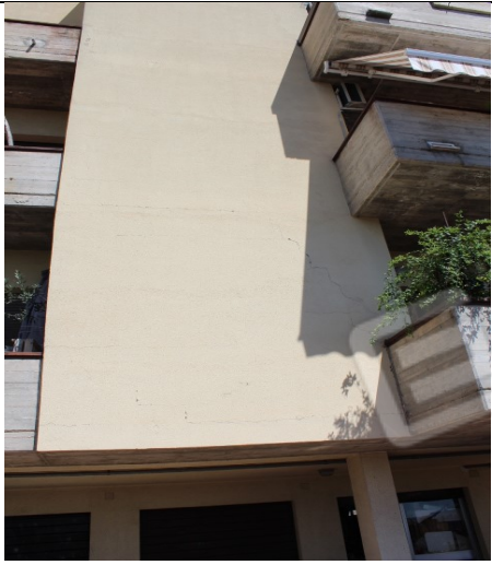
PARTICOLARE MURATURA CON LESIONI
