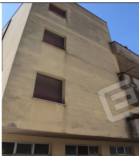
PARTICOLARE LESIONI SUL PROSPETTO NORD
