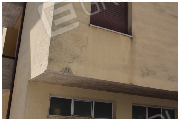
PARTICOLARE A NORD, DI DISTACCO DI CALCESTRUZZO E LESIONE ALLA MURATURA DI TAMPONAMENTO
