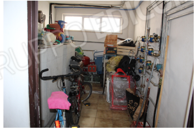
CENTRALE IDRICA CON VASCHE ACCUMULO ACQUA E CONTATORI ACQUA SINGOLI CONDOMINI
