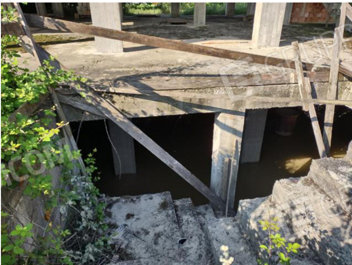
FOTO 8. Fabbricato in costruzione: scala di accesso dalla corte al piano interrato invaso del fango
