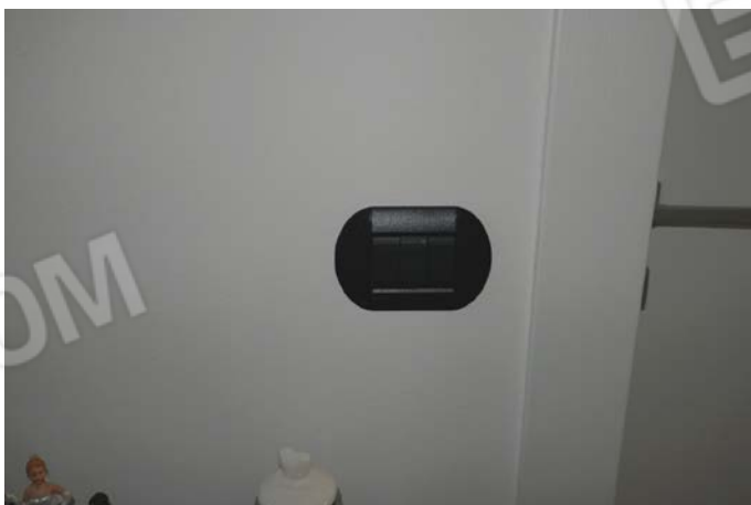
foto n.102 – particolare dei frutti per le prese e gli interruttori dell'appartamento
