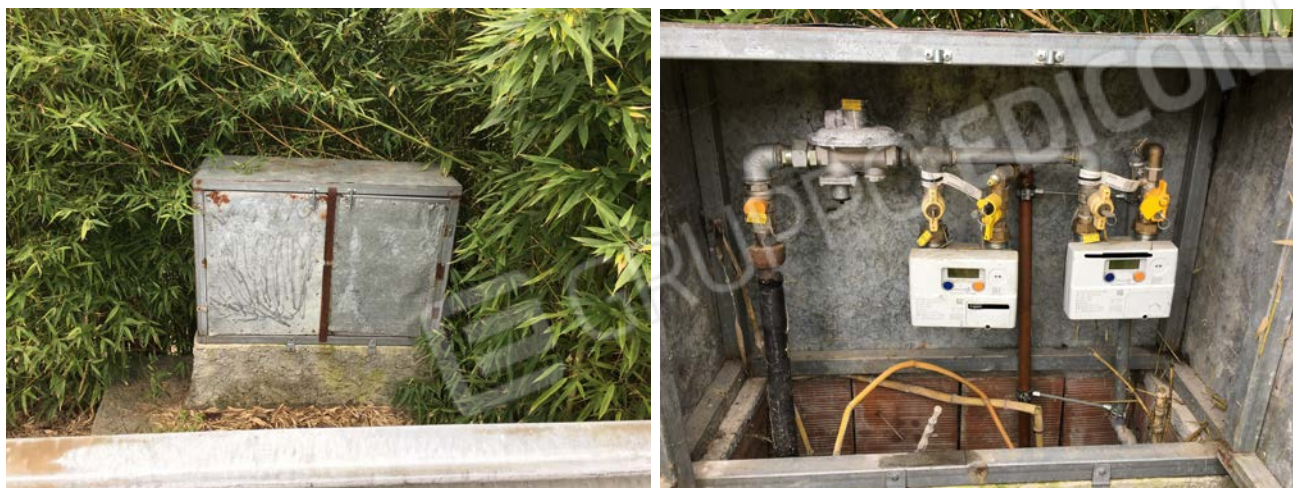
foto n.124-125 – veduta della nicchia e dei contatori del gas
