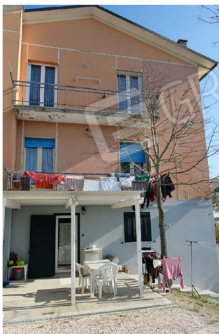
foto n.14-15 - veduta di parte del ripostiglio identificato con il sub.9 (bene comune non censibile), della tettoia realizzata senza titolo autorizzativo e della facciata del fabbricato (lato pc.139) ove è ubicata l'autorimessa, utilizzata impropriamente come appartamento.
