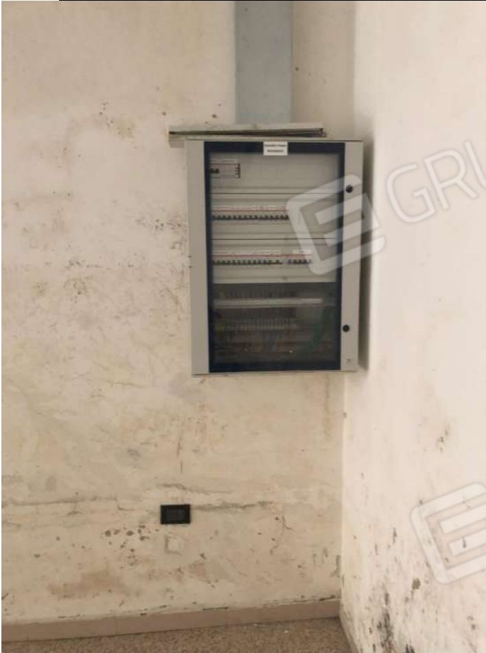
Foto 15- Piano 1° seminterrato – mostra (DETTAGLIO QUADRO ELETTRICO)
