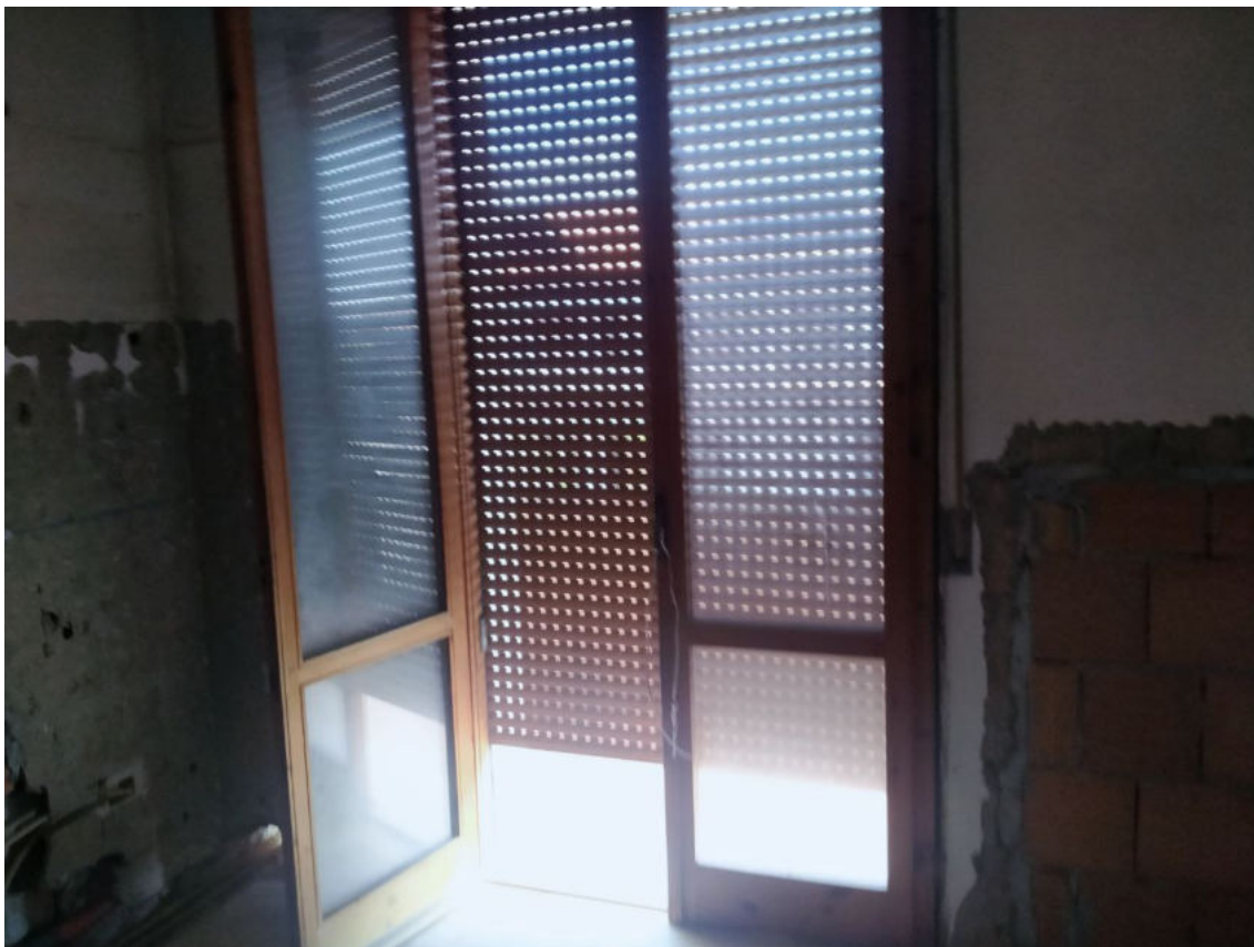
Fot. 10 – Vista dei lavori nella zona cucina. È prevista anche la sostituzione degli infissi esterni.
