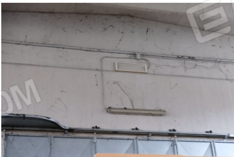
foto n.31-32-33 – particolare tipologia dell'impianto elettrico e del quadro elettrico generale
