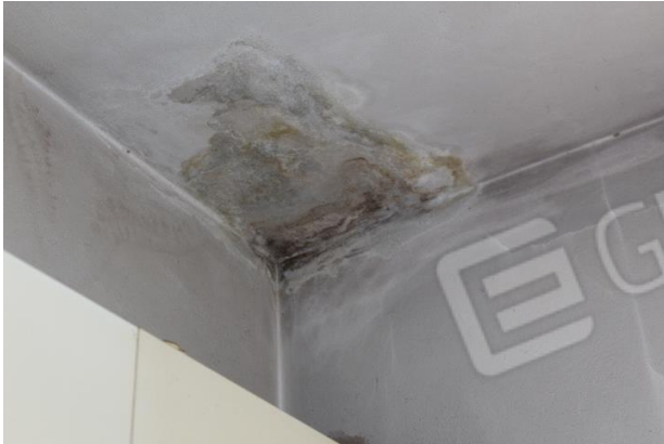
INFILTRAZIONE D'ACQUA ALLA CUCINA PIANO PRIMO
