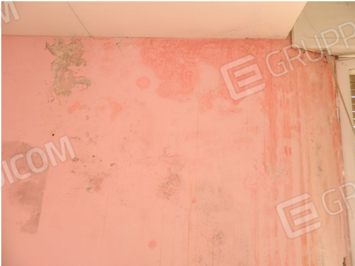
FOTO 14 – Dettaglio parete soggiorno: tracce di infiltrazioni d'acqua
