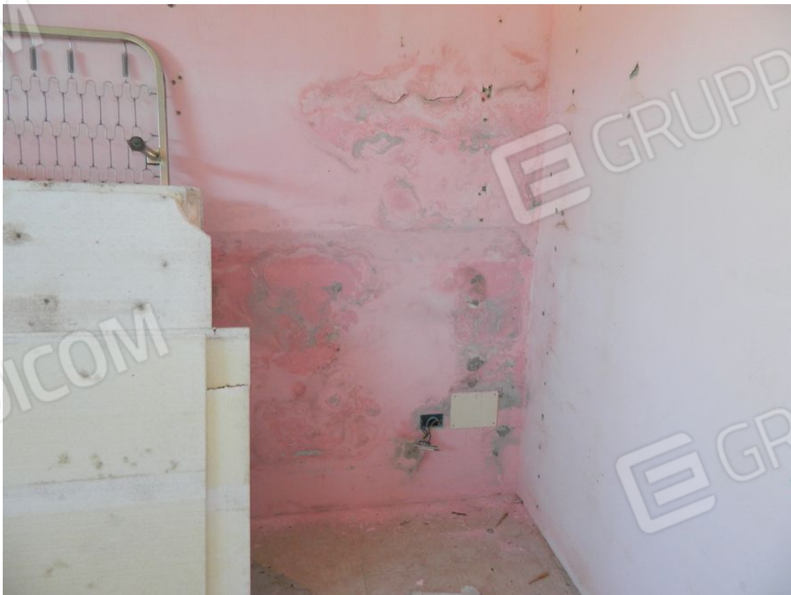
FOTO 8 – Locale di servizio: dettaglio parete con tracce di umidità
