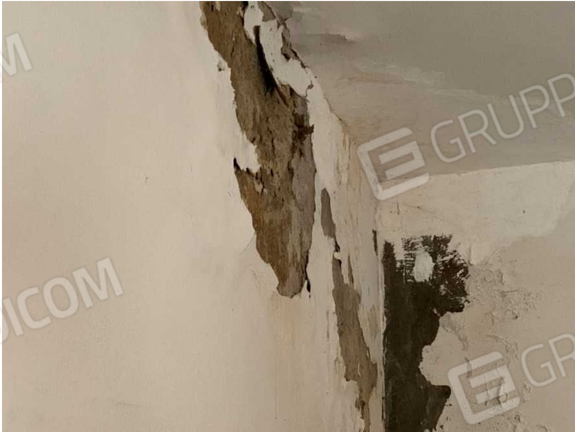
VANO SCALA PIANO PRIMO: PARTICOLARE DEGRADO INTONACO PER INFILTRAZIONI DALLA COPERTURA
