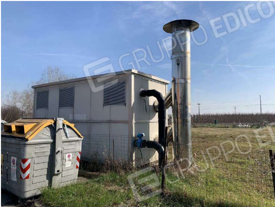
Foto 36: Centrale di teleriscaldamento
