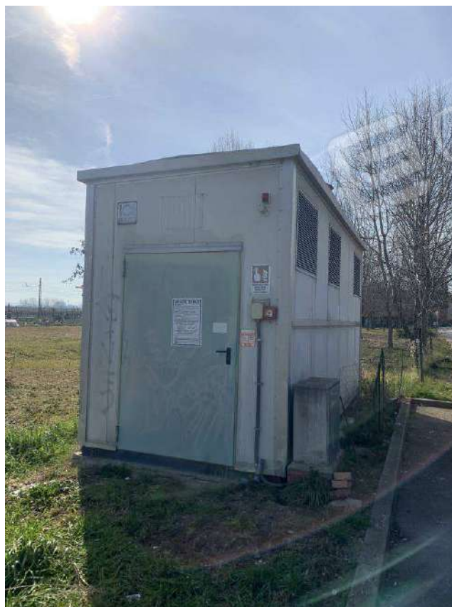
Foto 35: Centrale di teleriscaldamento
