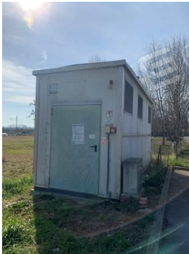
Foto 35: Centrale di teleriscaldamento
