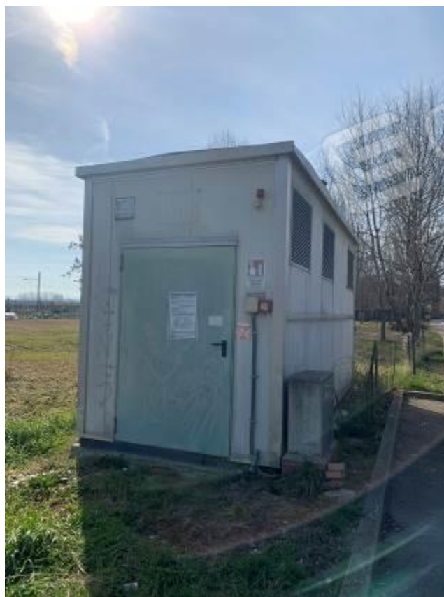
Foto 35: Centrale di teleriscaldamento
