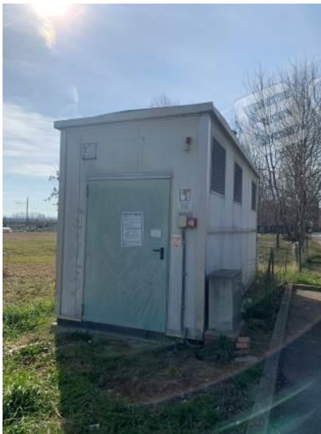
Foto 33: Centrale di teleriscaldamento
