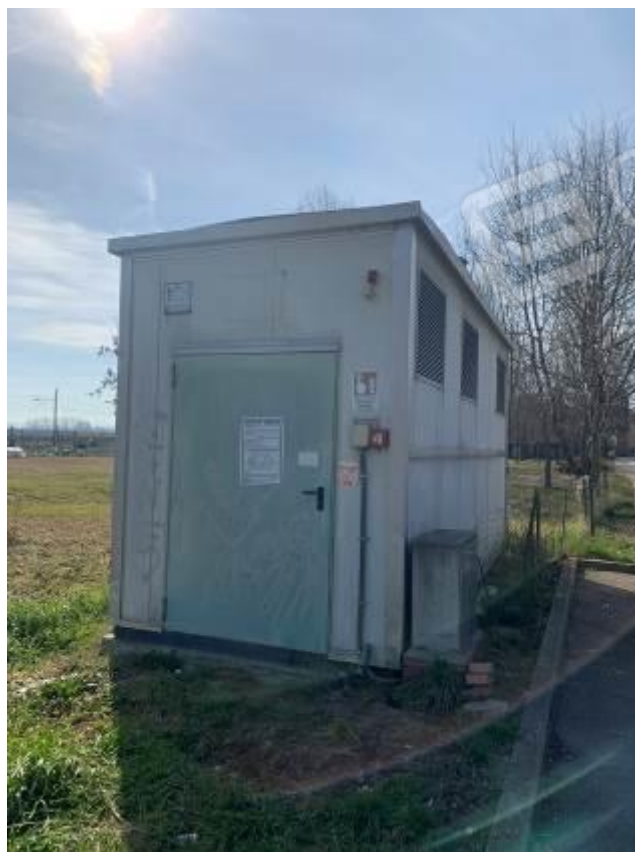
Foto 35: Centrale di teleriscaldamento
