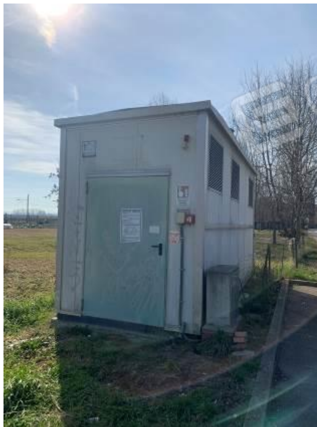
Foto 35: Centrale di teleriscaldamento
