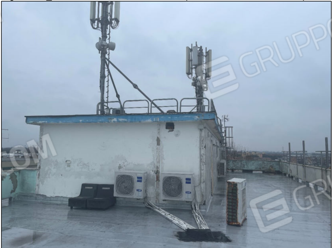
Fotografia 35_ Altra vista del terrazzo e dell'impianto di telecomunicazioni presente.
