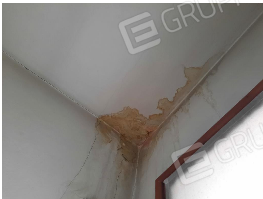
INFILTRAZIONI DAL SOFFITTO DEL BAGNO
