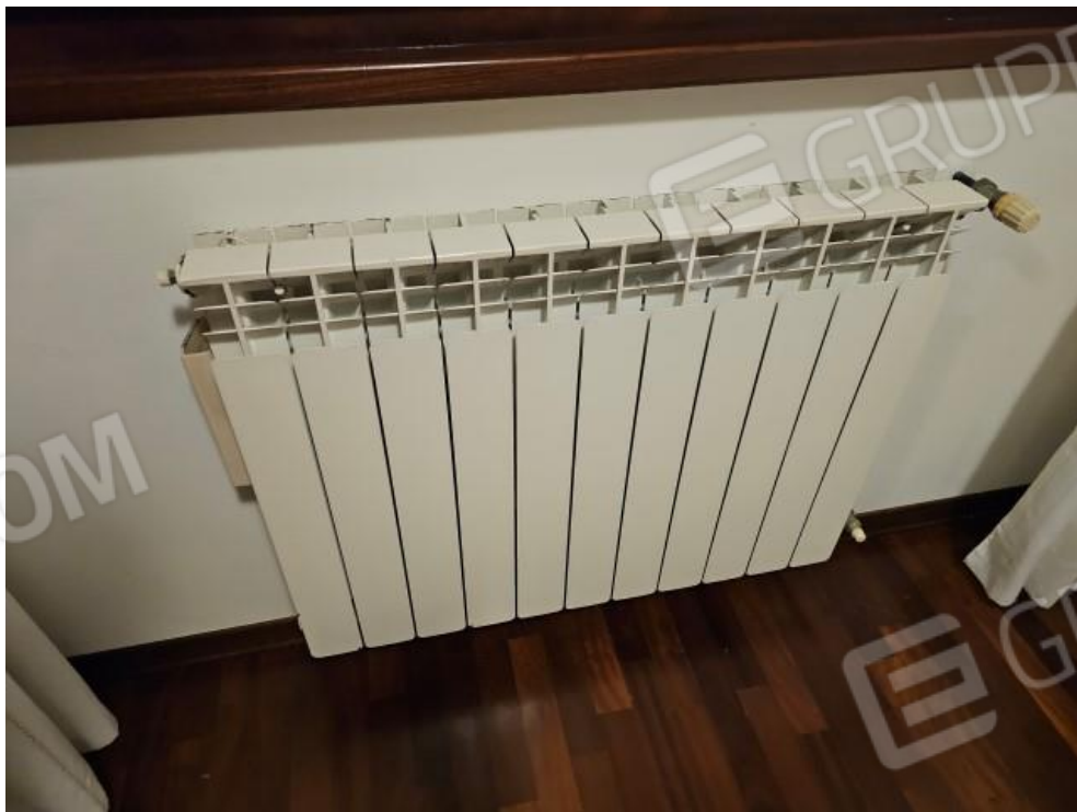
FOTO 20: PARTICOLARE RADIATORE (SUB. 4 – 1°P.)
