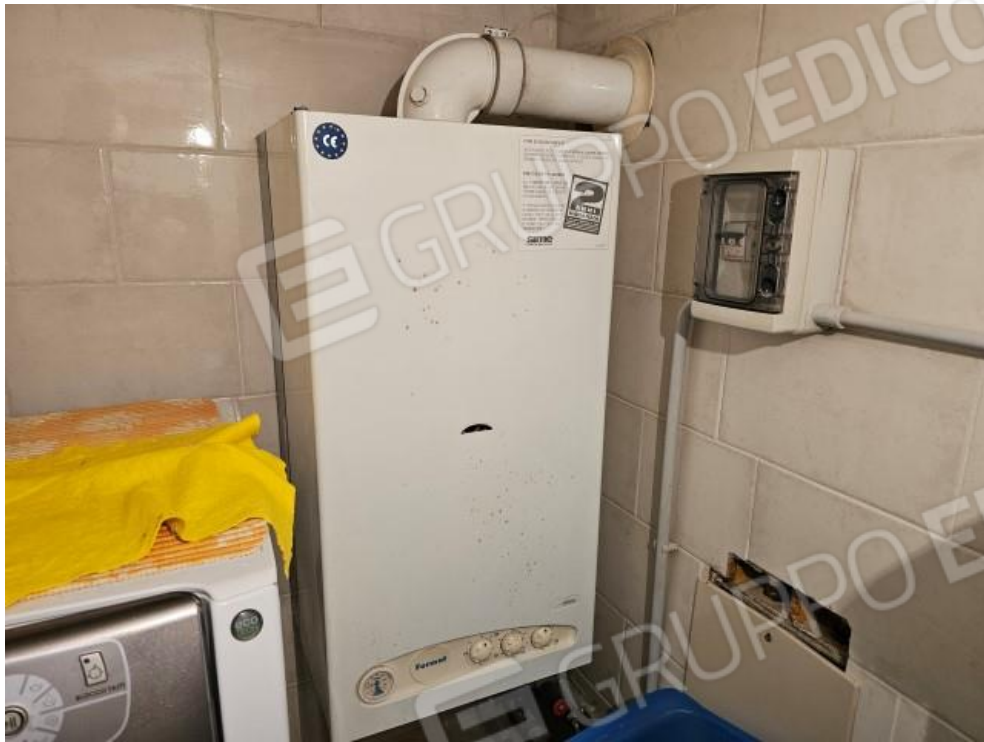
FOTO 19: CALDAIA (SUB. 4 – 1°P.)
