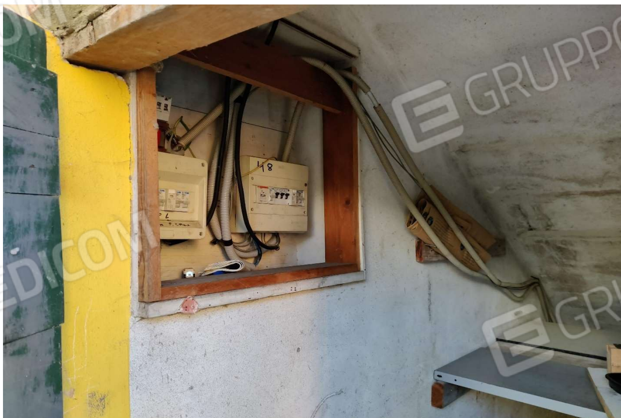
Foto n. 26 - Quadri elettrici delle due unità posti nel sottoscala esterno.
