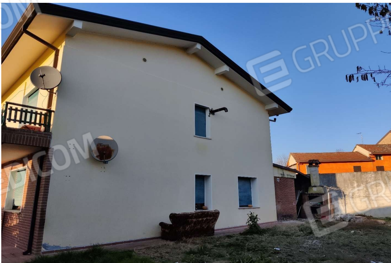
Foto n. 30 - Elementi delle lattoneria in distacco e sistema di ricezione satellitare con parabola esterna.
