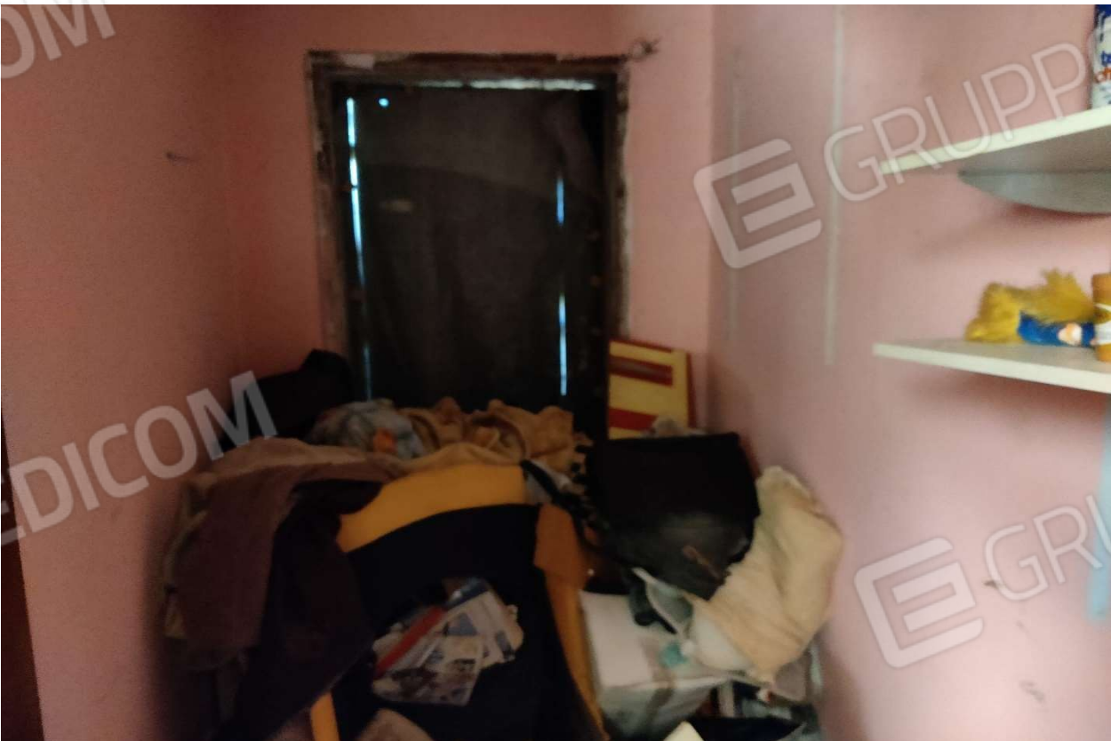
Foto n. 10 - Ripostiglio sulla sinistra nella zona giorno: in evidenza la mancanza del serramento della porta che da sull'esterno.
