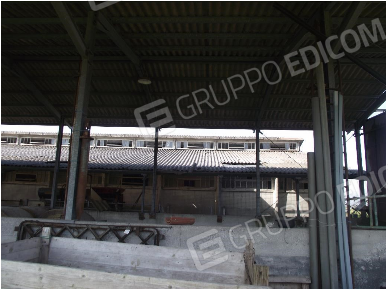
Foto 31 – lotto 2 – stato conservazione copertura stalla
