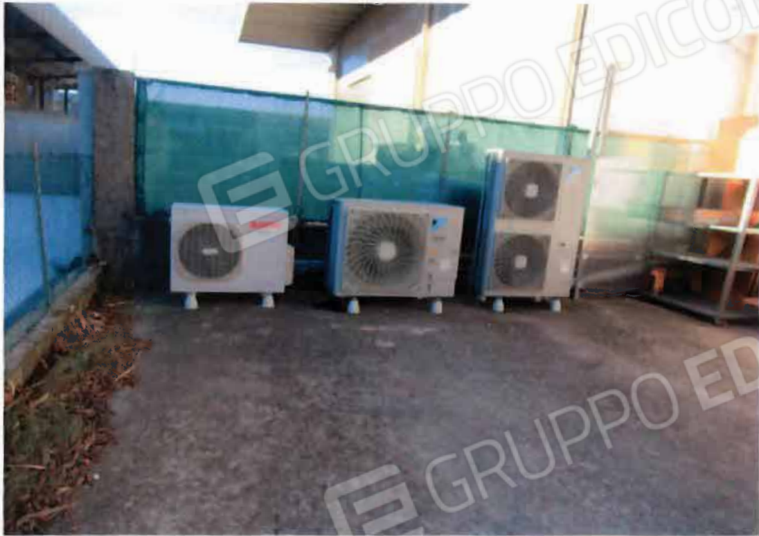
Foto 221: Pompa di calore Daikin Foto 223: Pompa di calore Sanyo
