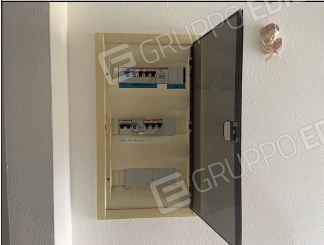
Particolare quadro elettrico
