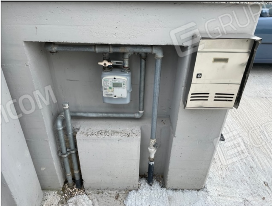
Contatore gas esterno
