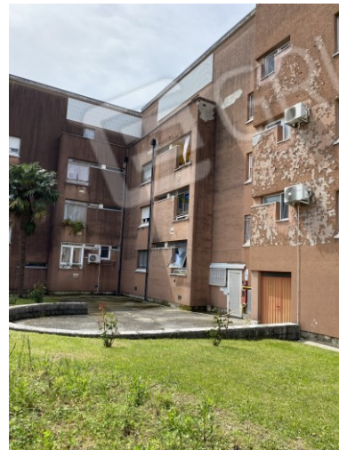
vista degrado pitture lato est
