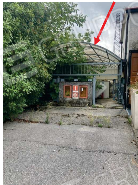
ulteriore particolare della tettoia abusiva lato Nord
