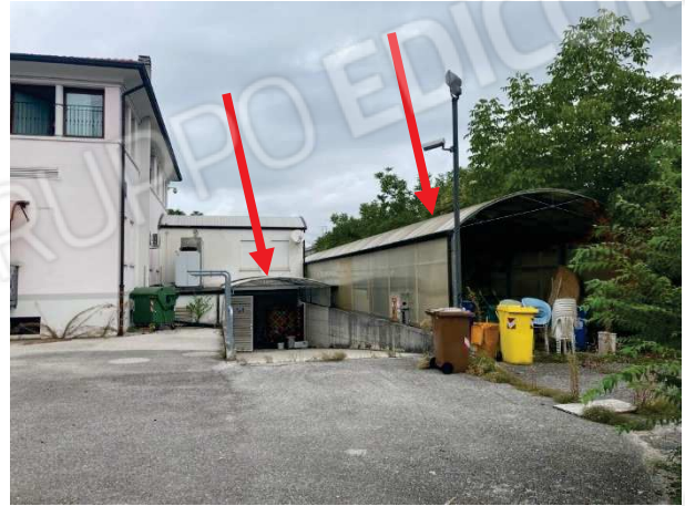
particolare delle due tettoie abusive lato Sud
