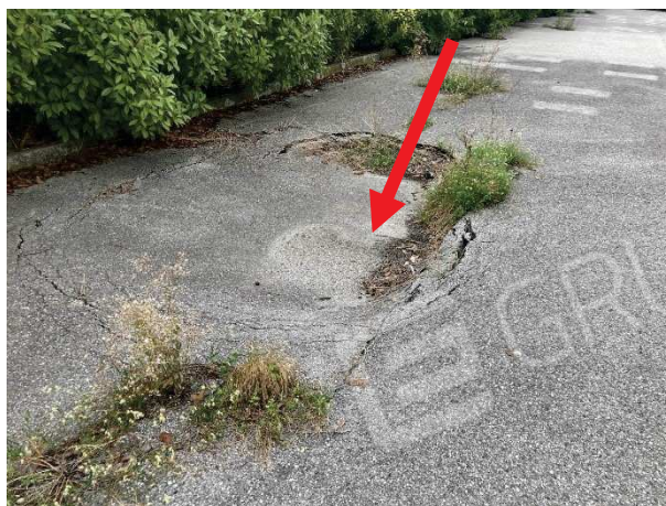
particolare degrado piazzale lato Ovest
