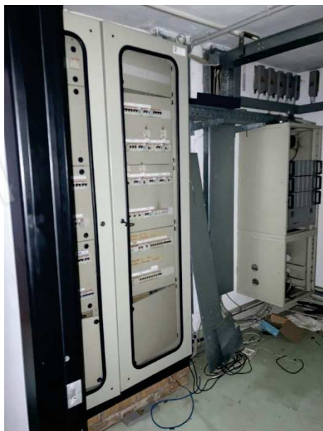
vista ripostiglio quadri elettrici al piano seminterrato
