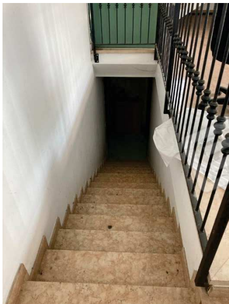
vano scala interno posto a Sud del fabbricato di collegamento tra piano rialzato e seminterrato
