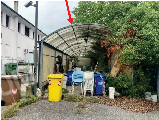
ulteriore particolare della tettoia abusiva lato Sud
