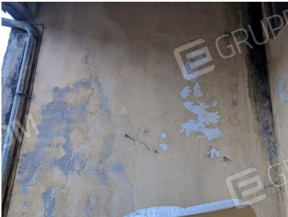
FOTO 36: SEGNI DI INFILTRAZIONE (Lato interno)
