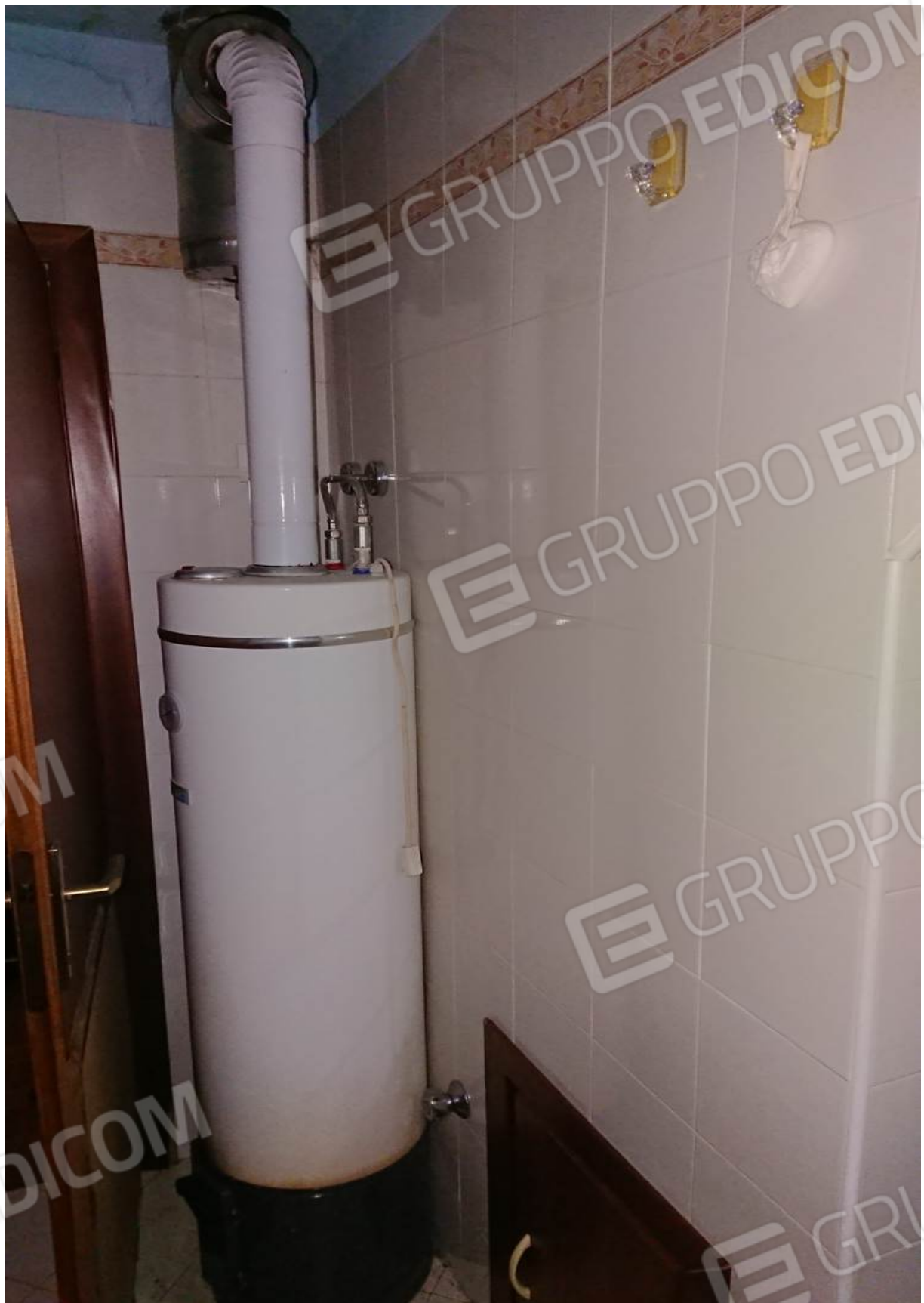
Foto n° 13 - 18/01/2022 - Comune di Caneva, foglio 21, part.156-157 – Boiler nella stanza da bagno.
