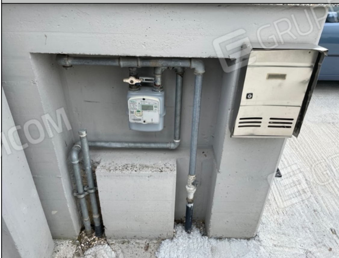
Contatore gas esterno
