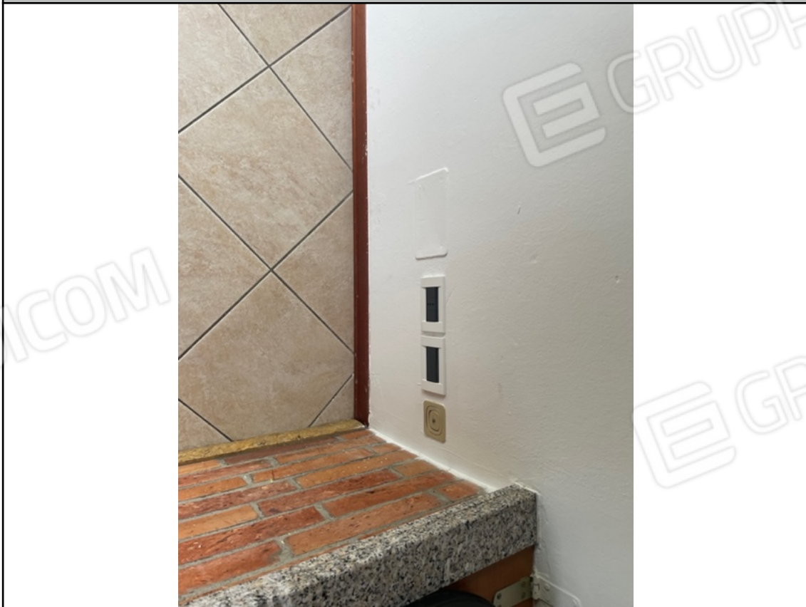
Particolare impianto elettrico e finiture parete
