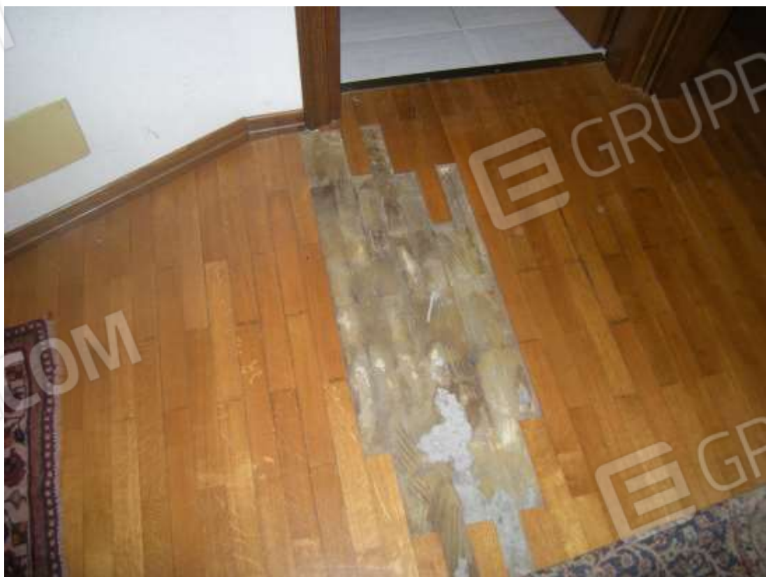
San Vito al Tagliamento, via Oberdan n. 84 – Danni al Parquet.
