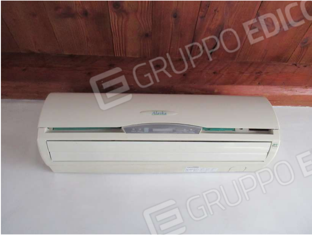
Foto 15: Climatizzatore Piano Terra
