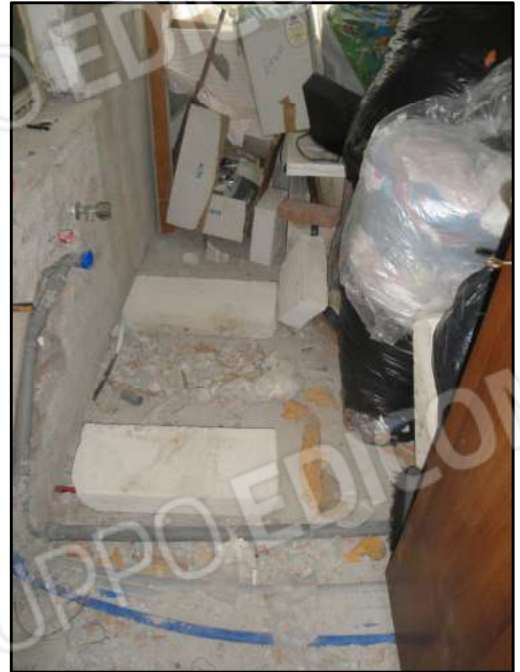
FOTO N. 13 BIS BAGNO IN CAMERA NON REALIZZATO
