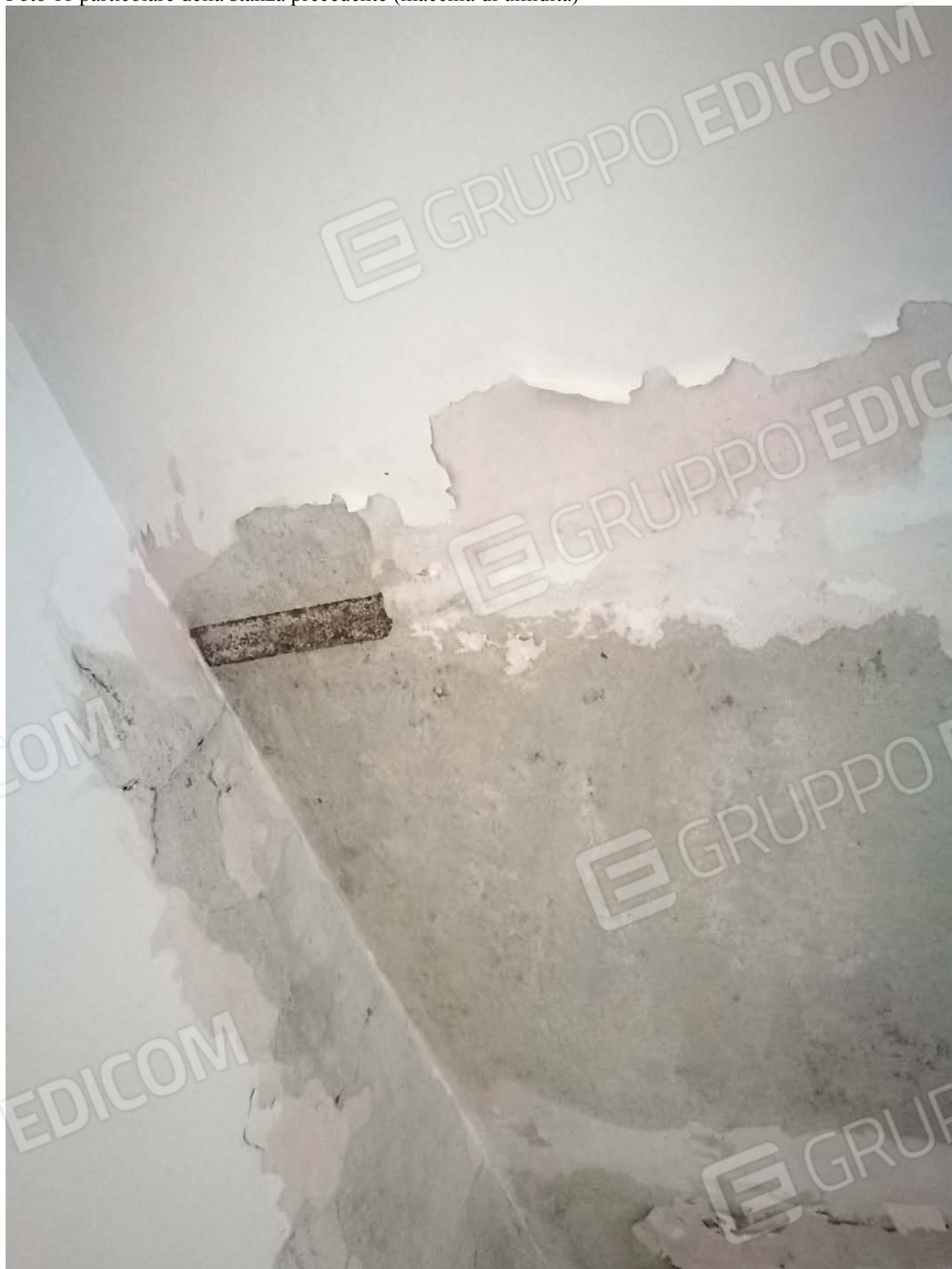
Foto 11 particolare della stanza precedente (macchia di umidità)
