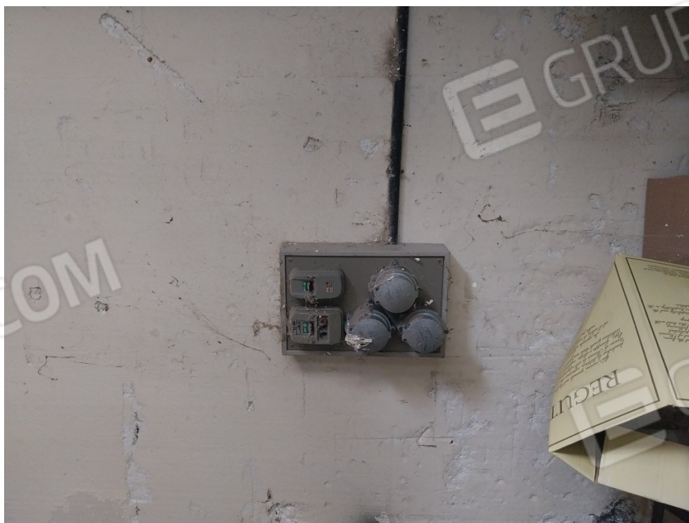
FOTO 4 – locale deposito impianto elettrico Sub 8 ex sub 1
