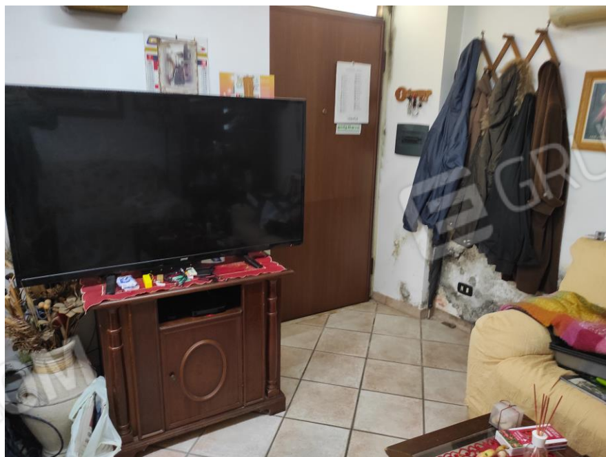
Vista parziale interna dell'ingresso sala da pranzo in cui si evincono le rifiniture e le macchie di umidità.
