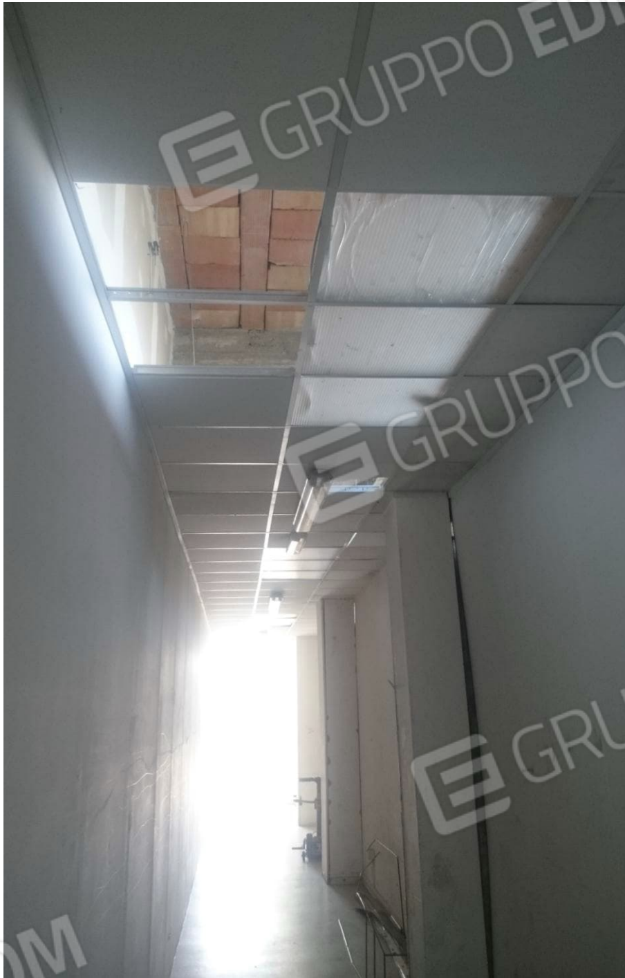
Figura 13 - Danni controsoffitto Piano Terra
