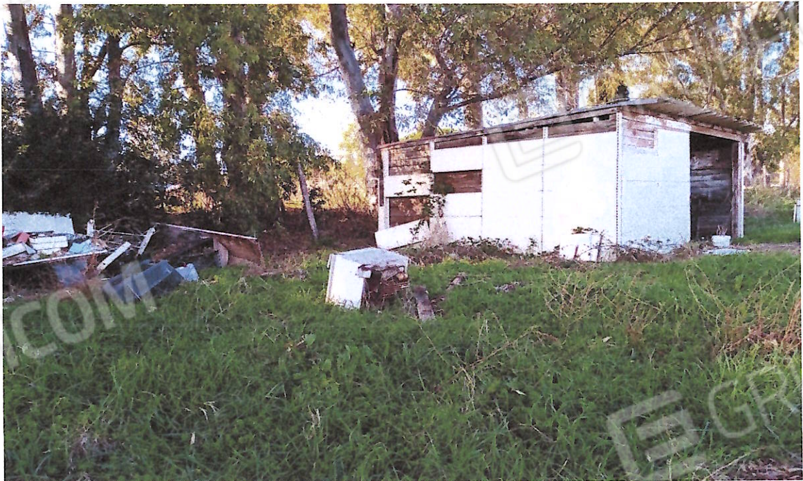
Foto 12 – capanno - manufatto precario non elgittimato esistente sul terreno
