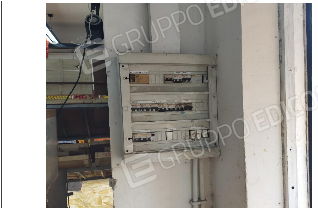
Foto 11 – quadro elettrico in dotazione
